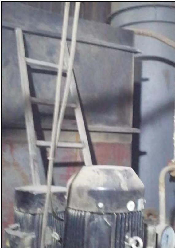
麻石水浴除尘器循环水箱
